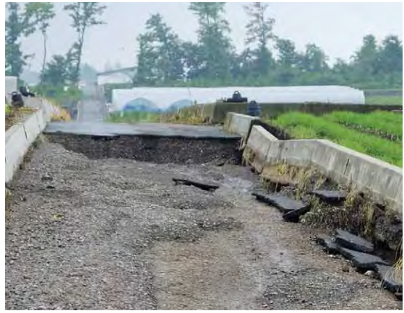
アスファルトが流出し通行不能に(赤城原)
