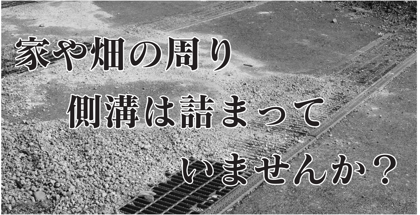
土砂で詰まってしまった側溝
