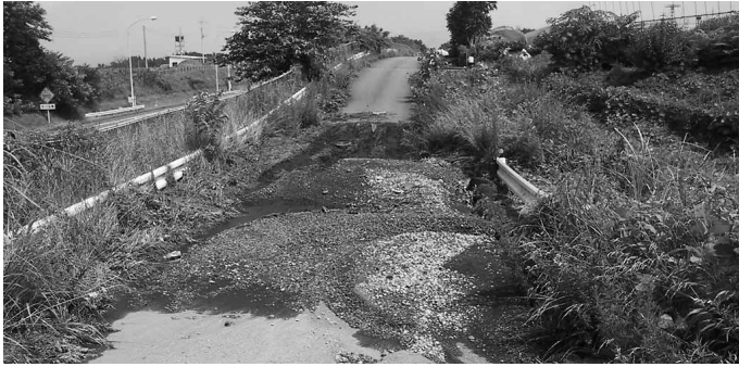
側溝からあふれ道路を覆う土砂
