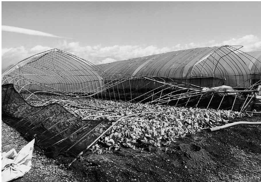
強風で倒壊したハウレンソウのビニールハウス
