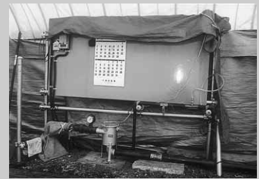
かん水施設の制御装置
